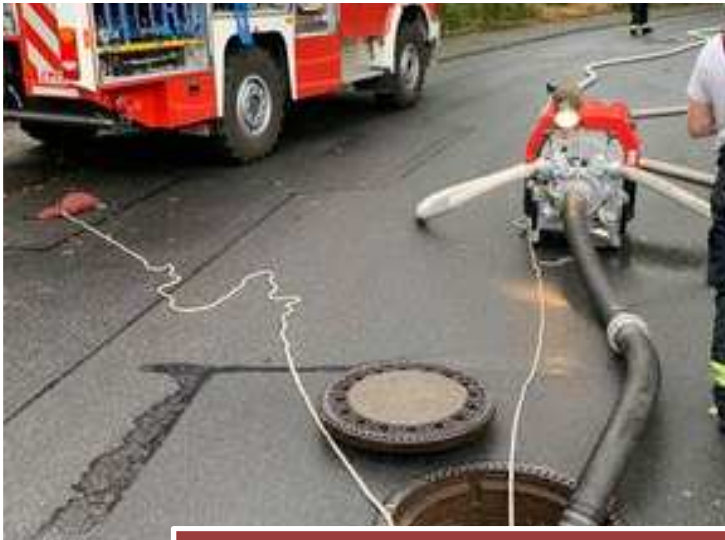
Kanalschächte mussten leer gepumpt werden
